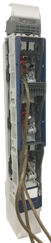
Conexión puesta a tierra Earthing device
